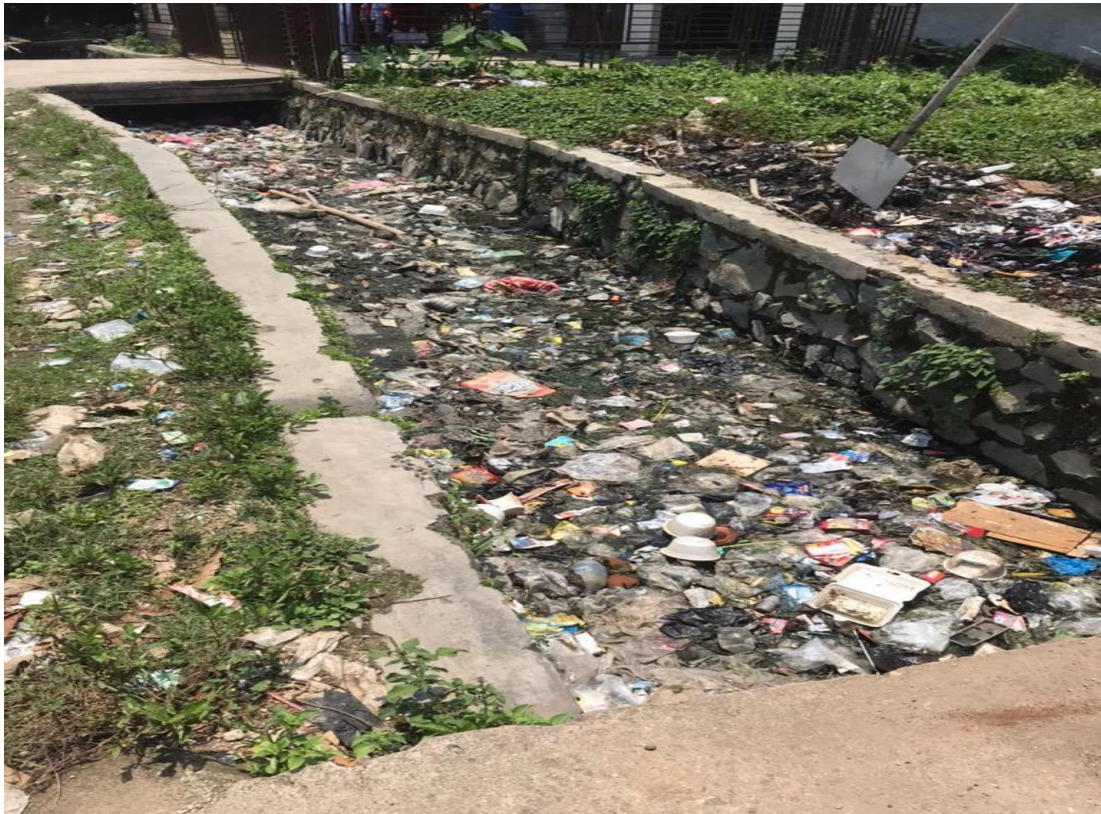
Gambar 9. Kondisi pembuangan sampah yang sembarangan hingga saluran air
