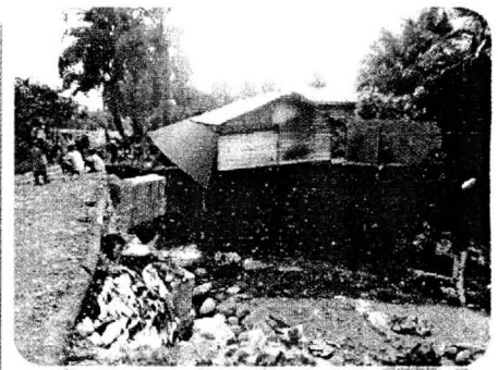
Longsor yang mengancam rutuhnya rumah dan putusnya jalur transportasi di Kecamatan Sei Bangai
